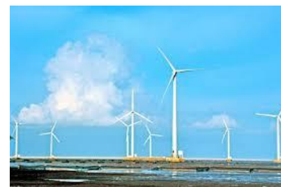
Dự án Điện gió Bạc Liêu
