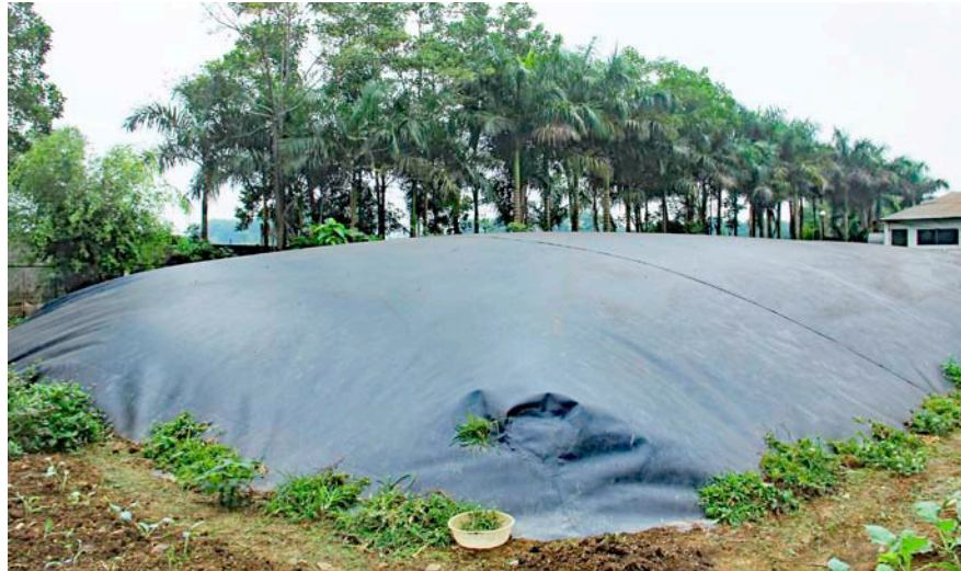
Gasdichtes Erdbecken, in dem Biogas produziert wird.
